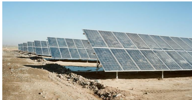
Şekil 2.10 Tozlanmış güneş paneli [37]
