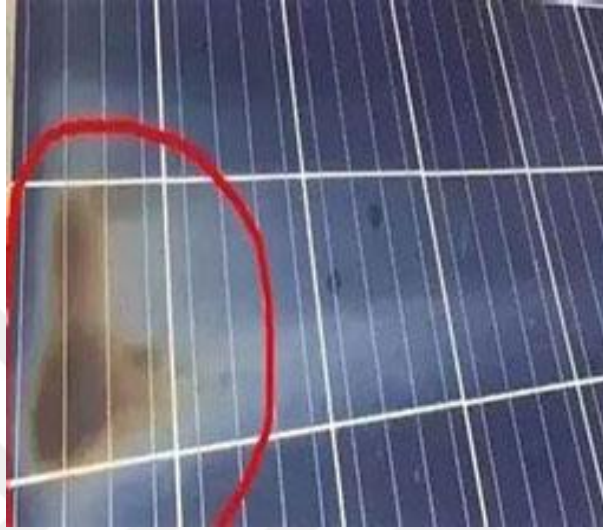
Şekil 2.11 Elektriksel hasarlı güneş paneli [37]
