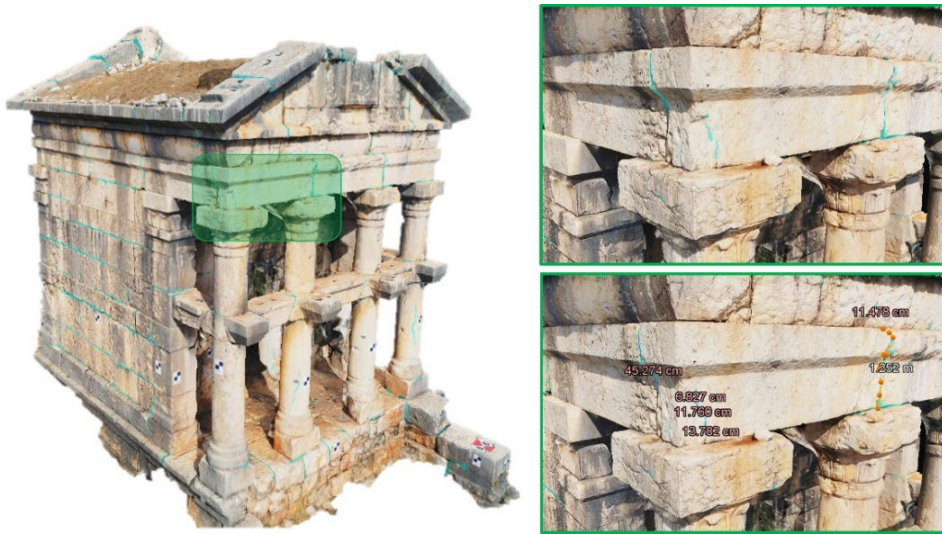
Şekil 4.32 Kale yapısında bir cephe üzerindeki çatlak uzunluğu ölçümü.
