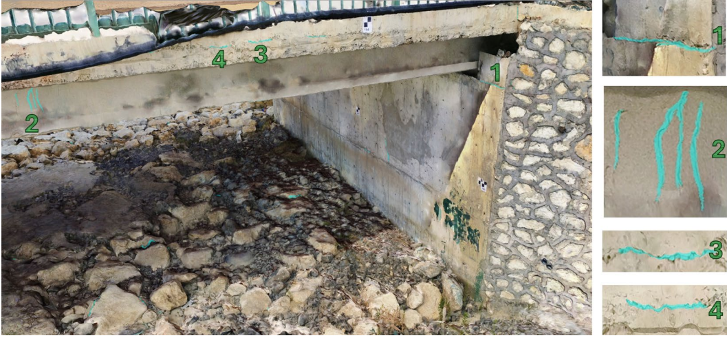
Şekil 4.14 Yan cephede ve üst destekte otomatik tespit edilen çatlaklar.
