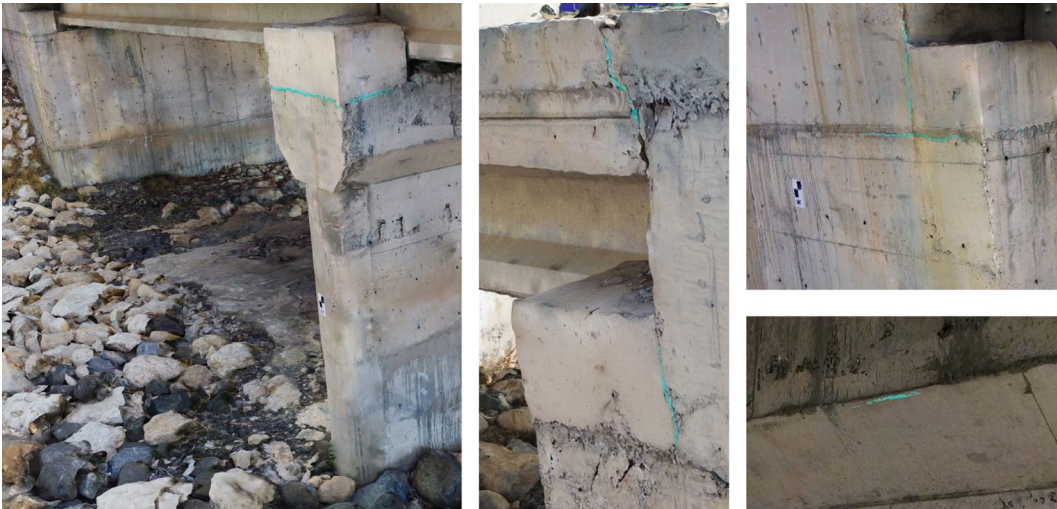
Şekil 4.15 Yan destek ve orta kolondaki otomatik tespit edilen çatlaklar.
