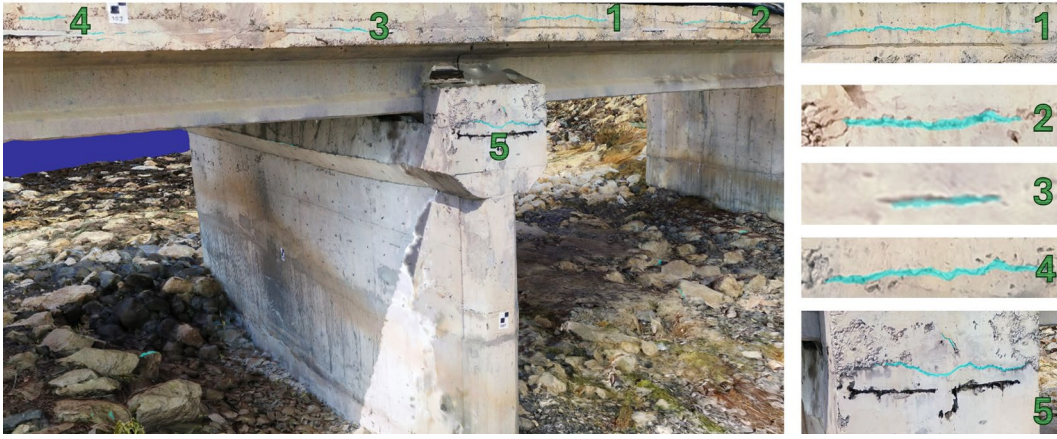
Şekil 4.13 Kolonlarda ve üst destekte otomatik tespit edilen çatlaklar.
