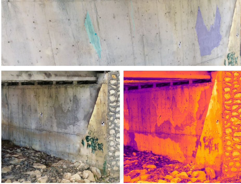
Şekil 4.27 Köprü yapısının korozyona uğramış bölgede termal dokulu Dİ model.
