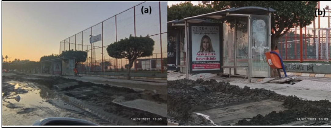
Resim 3.7. (a) Atatürk Bulvarı'nda alttaki zeminin sıvılaşmasının ardından zemin yüzeyine fişkırarak su birikintileri ve düşey deformasyon, (b) Otobüs durağındaki çökelti ve devrilen çöp kutusu, İskenderun, Hatay (Özener vd., 2024)
