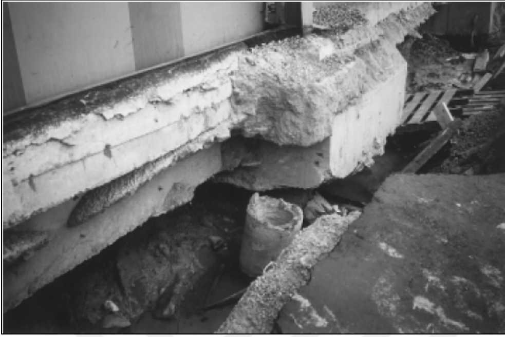
Resim 3.4. Port Island’da bir depoda kırık bir betonarme kazık, 1995 Kobe depremi (Soga, 1998)
