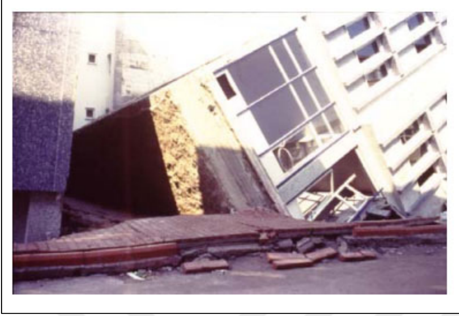
Resim 3.5. 1999 Adapazarı depremi sıvılaşma sonrası hasar gören yapı sıvılaşma kaynaklı taşıma gücü kaybı (Turoğlu, 2004)
