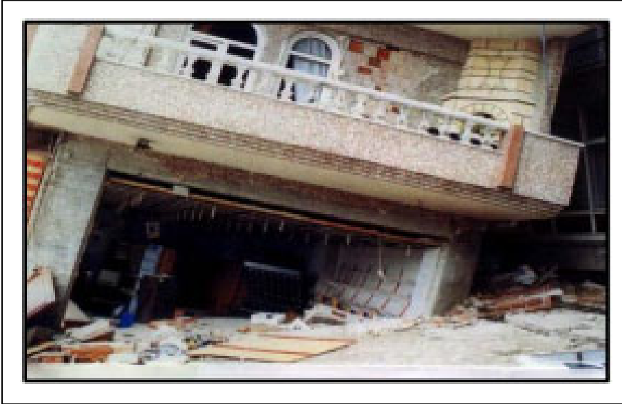
Resim 3.6. 1999 Adapazarı depremi sıvılaşma sonrası zemin oturması ve gömülmüş bina (Ulusay, 2000)
