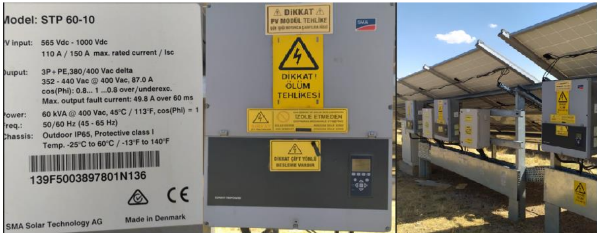
Şekil 7. GES tesisinde bulunan invertör marka ve model özellikleri
