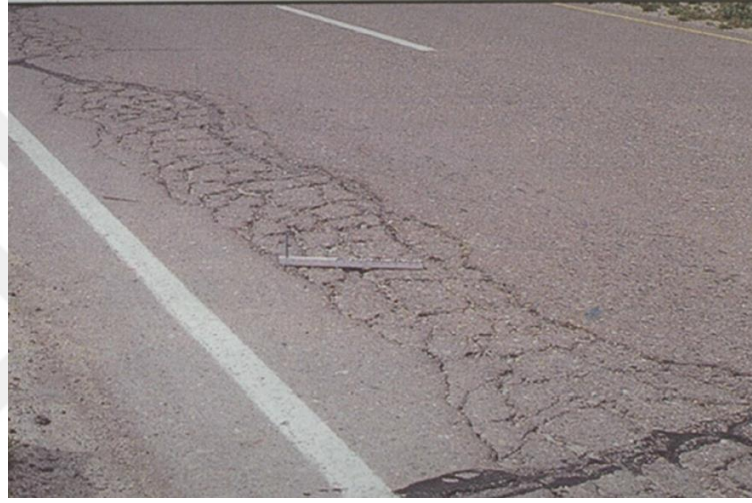
Şekil 1.26 : Tipik timsah sırtı çatlak oluşumu ve şiddet göstergesi
