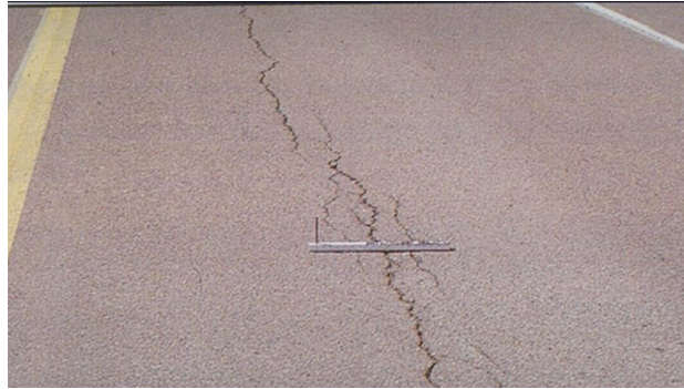
Şekil 1.27 : Boyuna çatlak örneği
