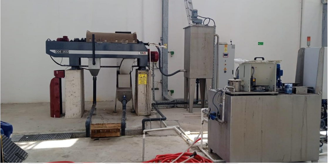
Şekil 3.13. Çamur susuzlaştırma ünitesi
