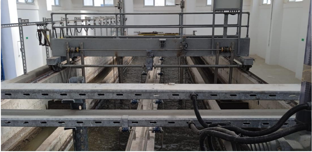
Şekil 3.8. Havalandırmalı kum ve yağ tutucu
