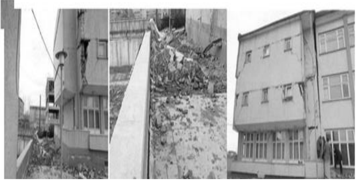
Şekil 3.6. Erzincan depremi sonucu hasar alan istinat duvarı nedeniyle yıkılan üst yapı
