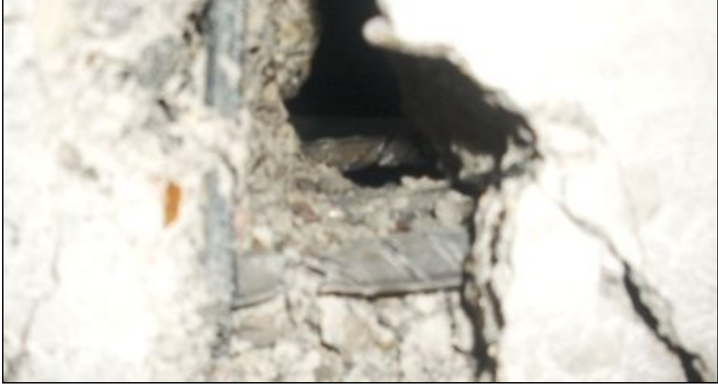
Resim 4.39.S9 deney elemanında kopan çekme donatıları
