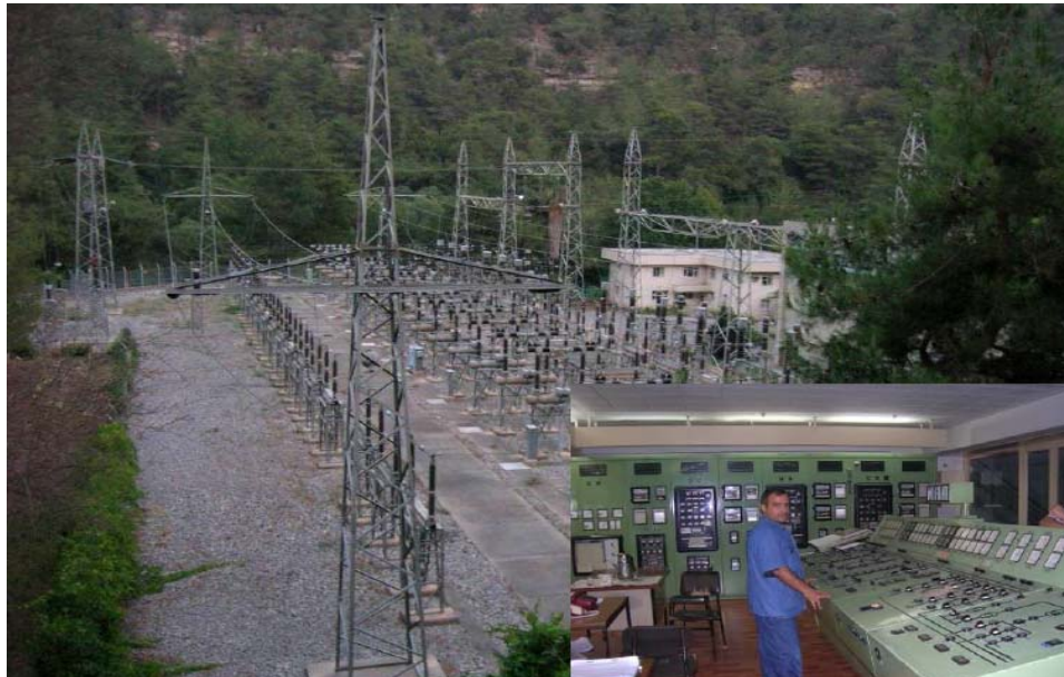
Foto 3.23. Kadıncık I Hidroelektrik Santrali ve Kumanda Merkezi
