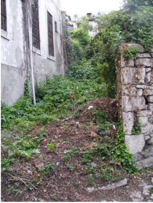
Resim 3.18. Yapının sağ yan cephesindeki duvarları yıkık WC mekanı
