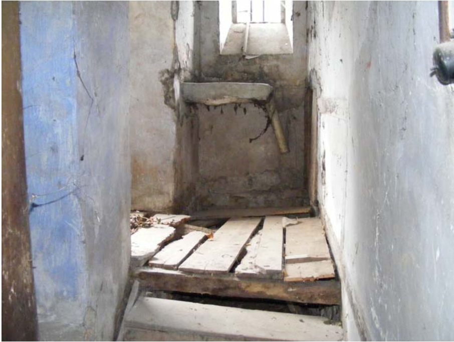
Resim 3.65. Z01-C numaralı holden geçilerek ulaşılan abdesthanenin (Z08) kırılmış döşemesi ve bozuk ahşap kaplaması
