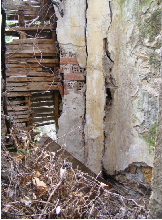
Resim 3.67. Z09 numaralı mekanın yıkık duvar bölümü
