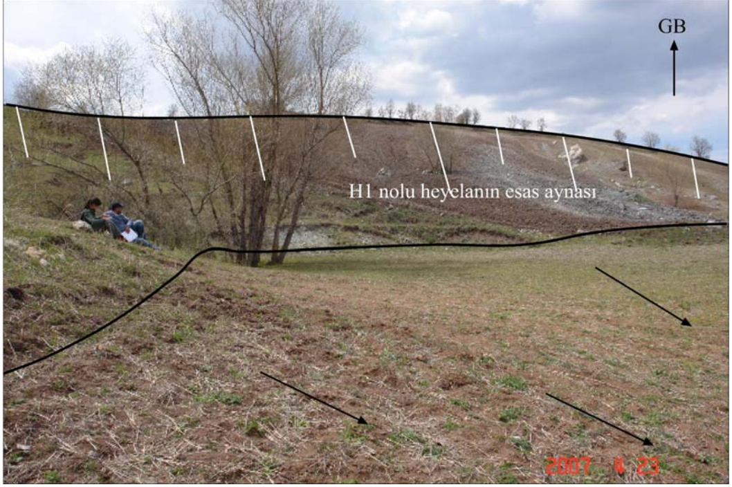
Şekil 5.6 H1 nolu heyelanın esas aynası
