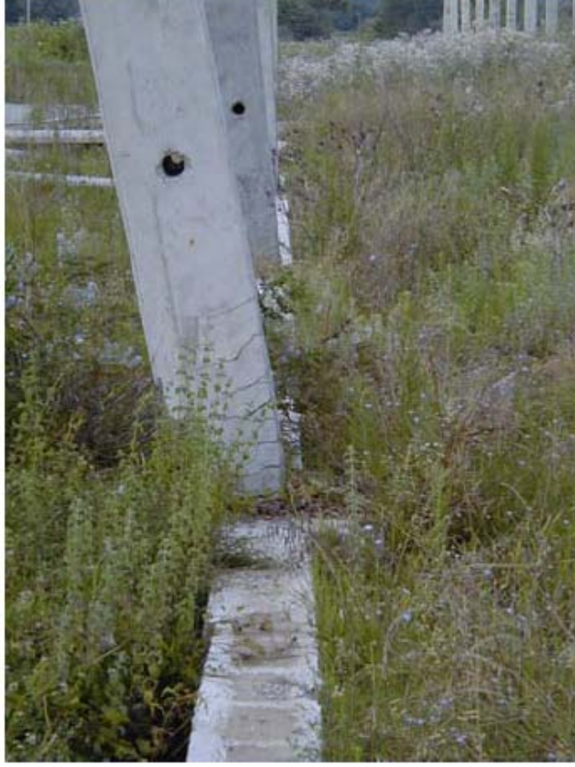
Şekil 4.3 Kolonda Eğilme Çatlakları
