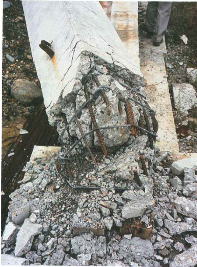
Şekil 4.7 Temel –Kolon Birleşim Bölgesindeki Hasar
