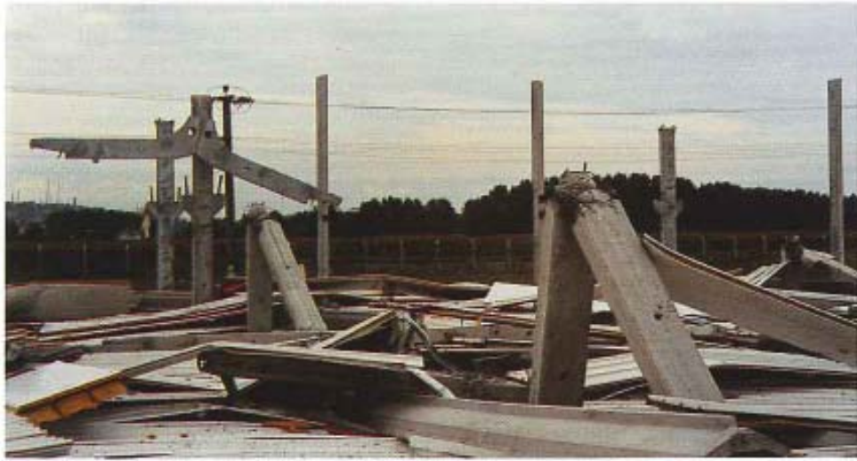
Şekil 4.6. İki Açıklıklı Yapılarda Orta Kolon Hasarı
