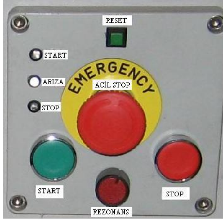
Şekil V.13 Sistemin kontrol paneli
