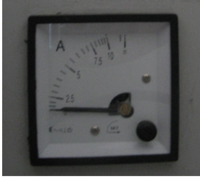
Şekil V.12 Sistemde kullanılan ampermetre
