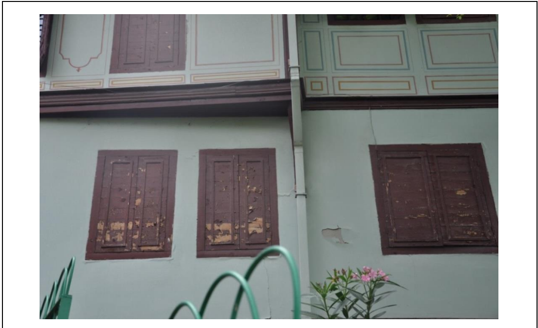
Şekil.4.34: Batı cephesi ahşap kepenklerde yıpranma.
