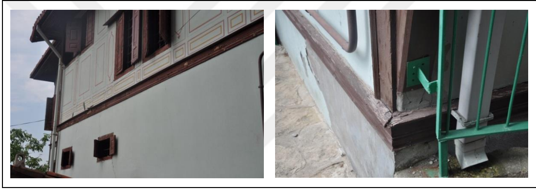
Şekil.4.35: Doğu cephesi ahşap silmelerde yıpranma.
