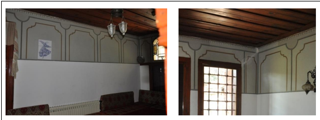
Şekil.4.36: 1 01 sofada kalem işlerine yapılan bilinçsiz müdahaleler ve nemden kaynaklı tahribatlar.
