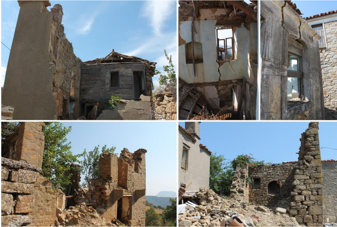
Şekil 5.15 : 2014 depremi sonrası tarihi sivil mimarlık örneklerinin durumu.
