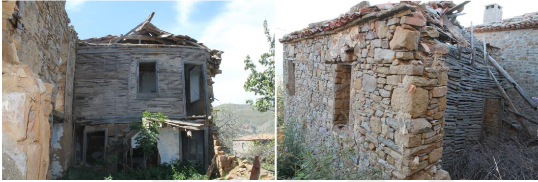
Şekil 2.81 : Hasar gören yapılarda görülebilen yapım sistemi detayları.
