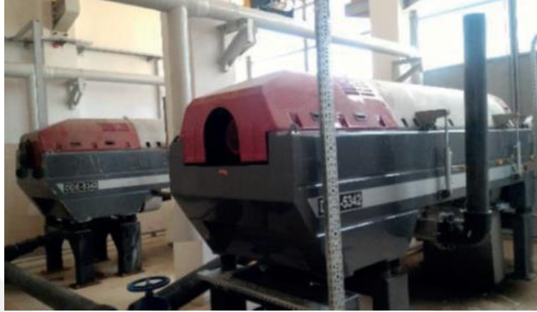
Şekil 1.10. Karaman AAT Mekanik Susuzlaştırma Ünitesi
