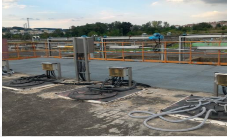
Şekil 1.8. Karaman AAT Geri Devir İstasyonu
