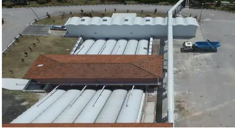
Şekil 2.2. Üzeri Kapatılan Giriş Yapısı Üniteleri
