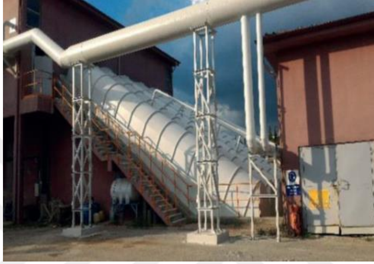
Şekil 1.2. Karaman AAT Giriş Terfi İstasyonu
