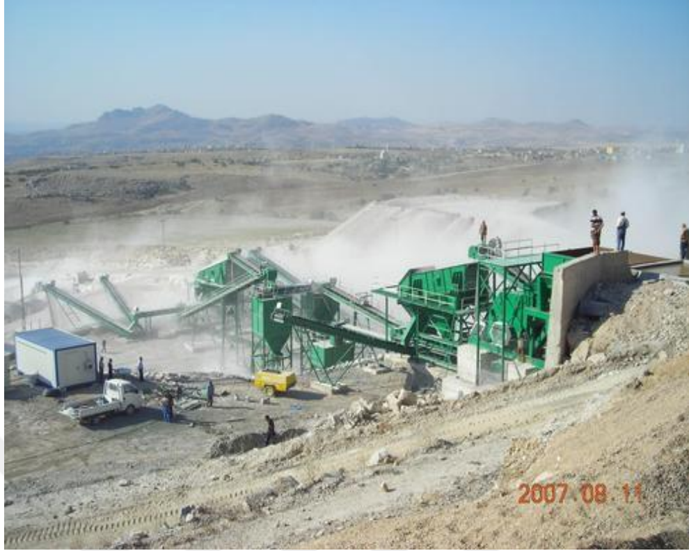
Şekil 2.5. Kırma ve eleme tesisi
