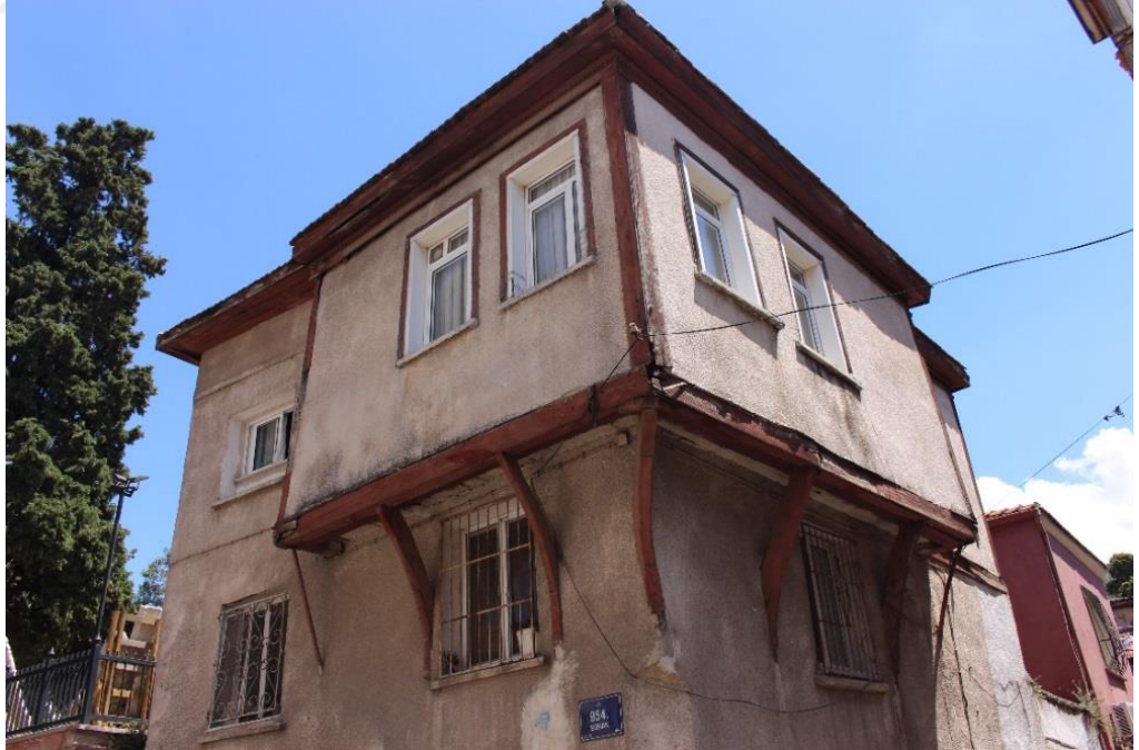
Fotoğraf 279. Pazaryeri Mahallesi, 954 Sok., No:2- 2A, Konak adresindeki konutun konutun çıkması.
