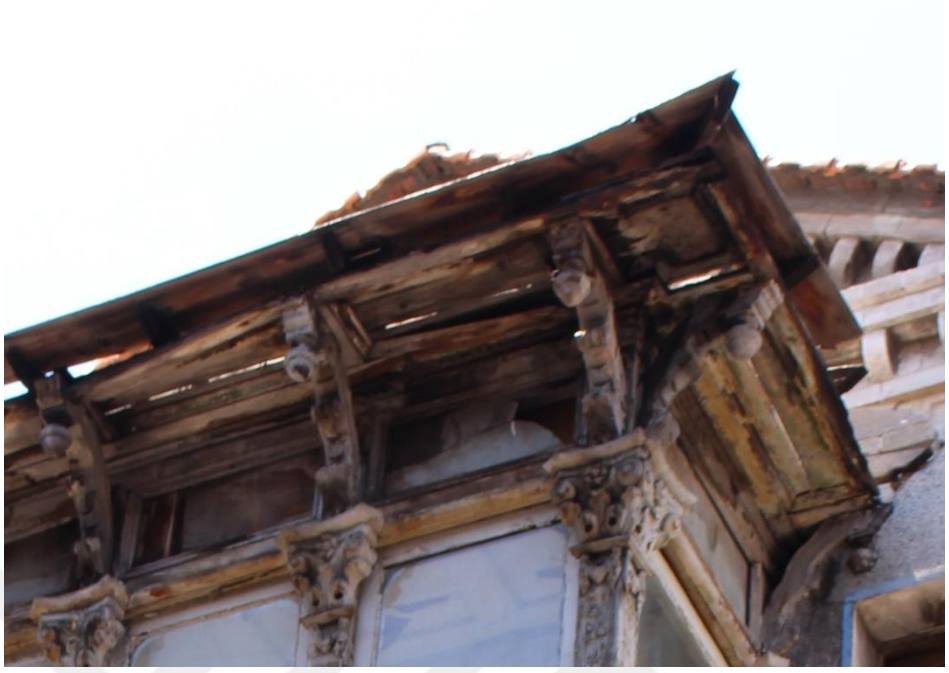
Fotoğraf 204. Kurtuluş Mahallesi, 943 Sok., No: 22-22 A, Konak adresindeki konutun cumba saçak alt yüzeyi.
