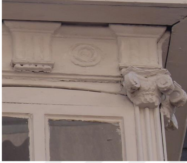
Fotoğraf. 85. Alsancak Mahallesi, Cumhuriyet Bul., No:240, Konak adresindeki konutun cumba pencere üstü,
