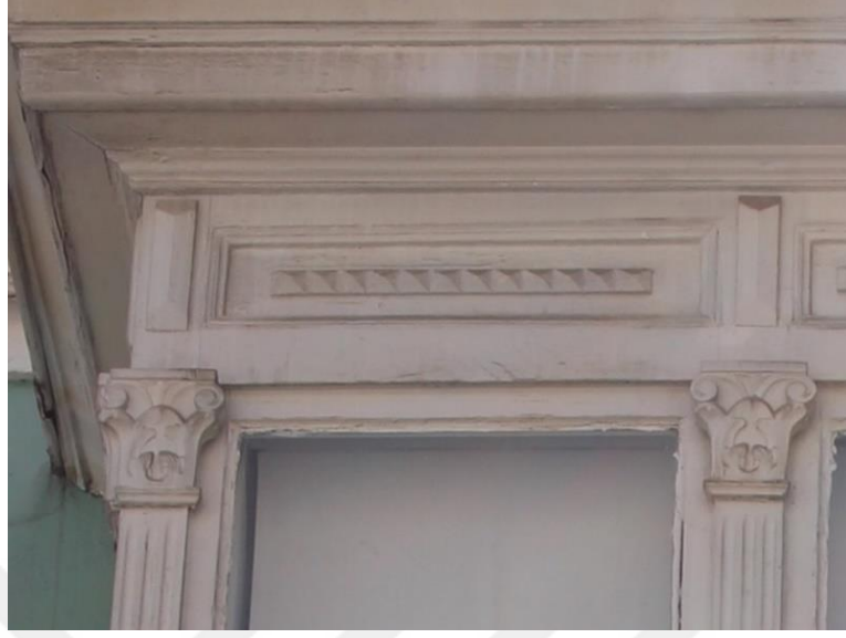
Fotoğraf 70. Alsancak Mahallesi, Cumhuriyet Bul., No:252, Konak adresindeki konutun cumba pencere üstü.
