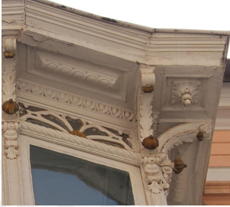
Fotoğraf 74. Alsancak Mahallesi, Cumhuriyet Bul., No:248, Konak adresindeki konutun cumba pencere üstü.
