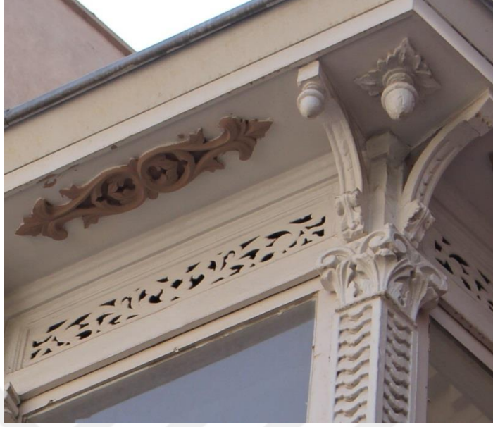
Fotoğraf 260. Donanmacı Mahallesi, Kemalpaşa Cad., No:89, Karşıyaka adresindeki konutun cumba saçak alt yüzeyi.
