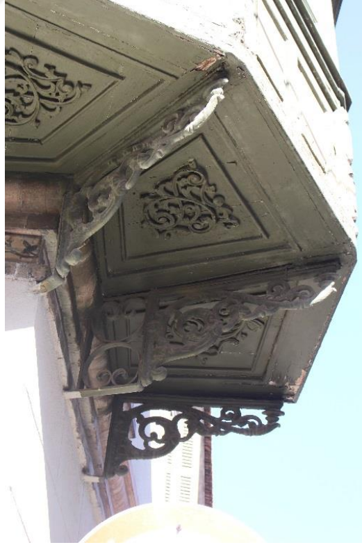
Fotoğraf 55. Mithatpaşa Mahallesi, 211 Sok., No:10-12, Konak adresindeki konutun cumba alt yüzeyi.
