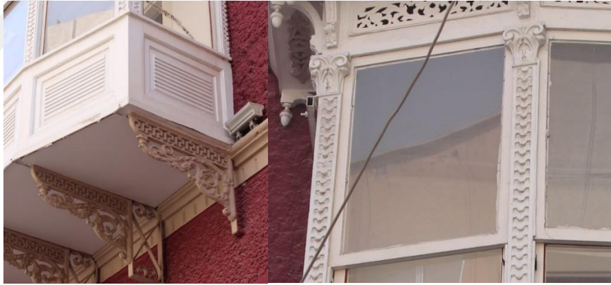
Fotoğraf 261. Donanmacı Mahallesi, Kemalpaşa Cad., No:89, Karşıyaka adresindeki konutun cumba konsolları ve pencere kayıtları.
