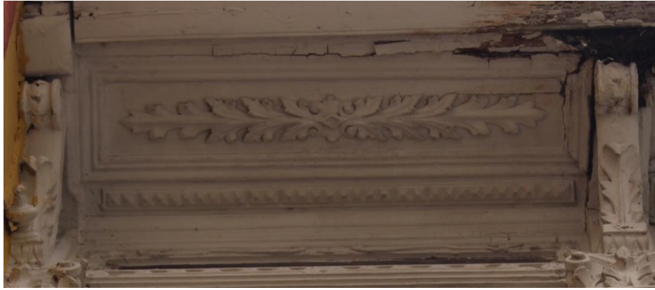
Fotoğraf 8. Güzelyalı Mahallesi, 59 Sok., No:17, Konak adresindeki konutun cumba saçak alt yüzeyi.
