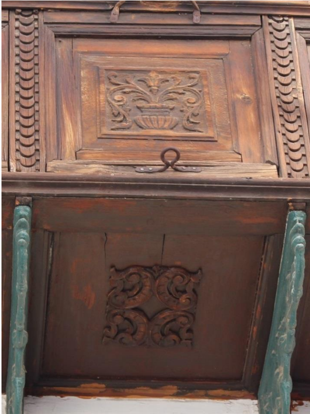
Fotoğraf 46. Mithatpaşa Mahallesi, 211 Sok. No:2 Konak adresindeki konutun cumba korkuluk panosu ve cumba alt yüzeyi.
