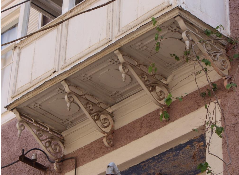
Fotoğraf 61. Turgut Reis Mahallesi, Şehit Kemal Keser Sok., No:59- 59 A, Konak adresindeki konutun cumba alt yüzeyi ve konsolları.
