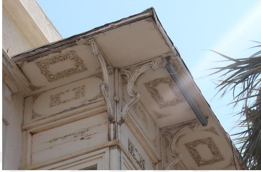
Fotoğraf 158. Alsancak Mahallesi, Atatürk Cad., No: 364 A, Konak adresindeki konutun cumba saçak alt yüzeyi.
