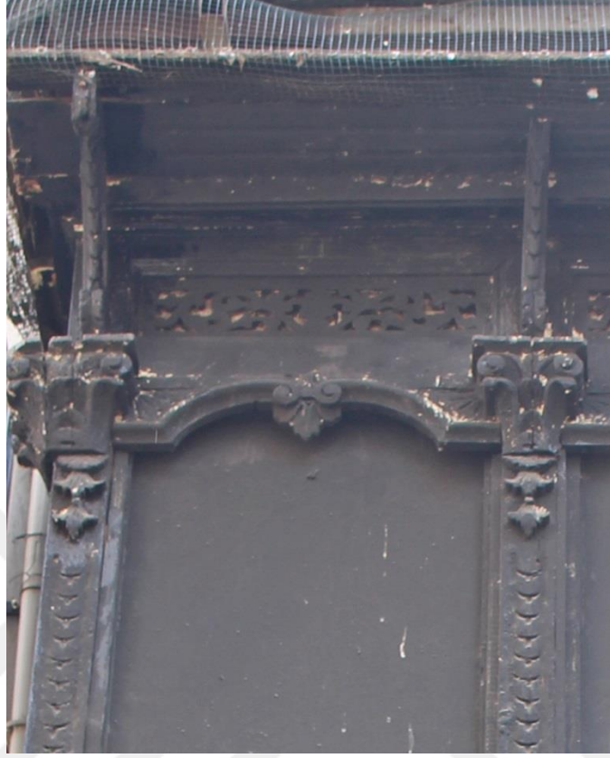
Fotoğraf 264. Donanmacı Mahallesi, Hüseyin Çağlayan Sok., no:6, Karşıyaka adresindeki konutun cumba pencere üstü.
