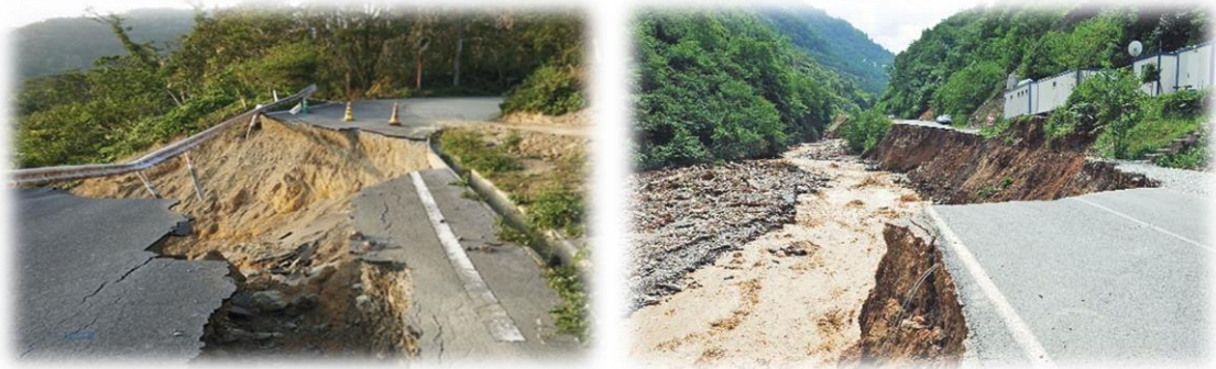
Şekil 3.26. Yağış sonucu oluşan toprak kaymasının altyapıya verdiği hasar.
