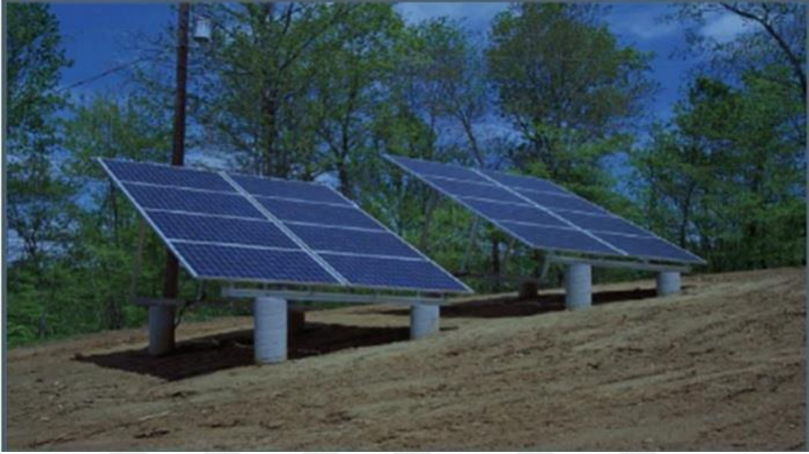
Görsel 2.2. Eğimli araziye kurulmuş fotovoltaiik sistem görüntüsü (Şençiçek, 2017)
