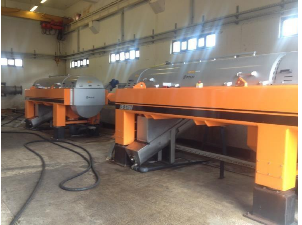
Şekil 1.3. Çalışmanın gerçekleştirildiği atıksu arıtma tesisindeki yatay dekantör (Adana Su ve Kanalizasyon İdaresi)
