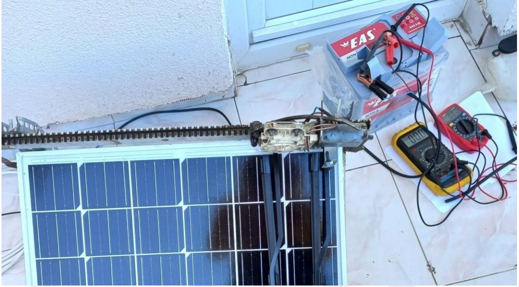
Şekil 3.16. Akünün güneş paneline bağlantısı.
