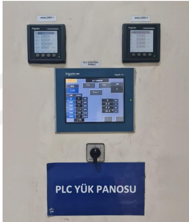
řekil 2.3 Yk bankası kontrol paneli
