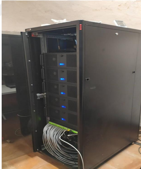
Şekil 6. 4: Şerefiye Sarnıcı'ı deposundaki sistem kabini (Şerefiye Sarnıcı İşletme Şefinin Arşivinden, 2023)
