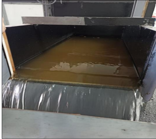
Şekil 2.4. Açık kanalın sonundaki çıkış tankına monte edilen keskin kenarlı metal savak (geniřliđi 50 cm ve yüksekliđi 29,5 cm).
