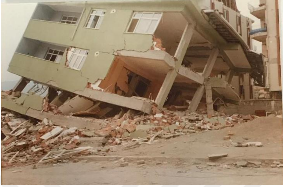
Şekil 3.4. Kolon - kiriş birleşim bölgesinde meydana gelen hasardan dolayı tümüyle yıkılmış bir bina (1999 Marmara depremi)
