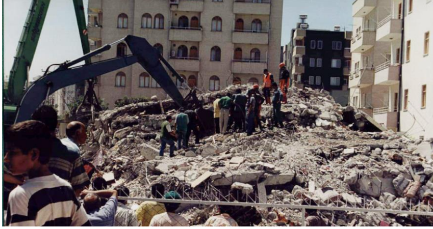
Şekil 3.2. Depremde kolon - kiriş birleşim bölgelerinin hasarı sonucu toptan göçen bina (1998 Adana Depremi) (AFAD, 2022)
