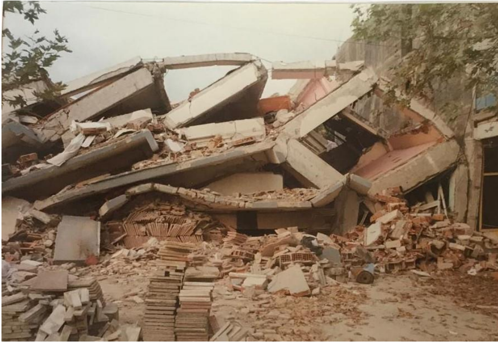
Şekil 3.5. Depremde kolon - kiriş birleşim bölgeleri tamamen dağıldığı için tümüyle yıkılmış bir bina (1999 Marmara depremi)
