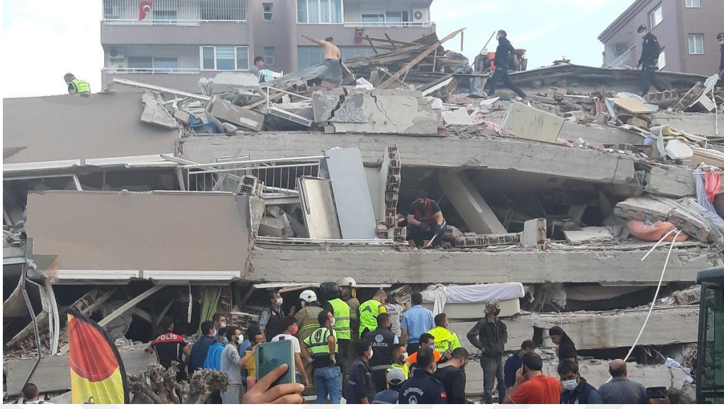
Şekil 3.8. 2020 İzmir depreminde kolon - kiriş birleşim bölgeleri hasar görmüş ve yıkılan bir betonarme bina (SÖZCÜ GAZETESİ, 2022)
