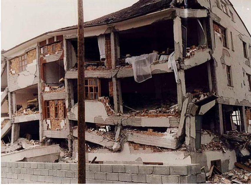
Şekil 3.1. Kolon - kiriş birleşim bölgesi hasarı (1992 Erzincan Depremi) (AFAD, 2022)
