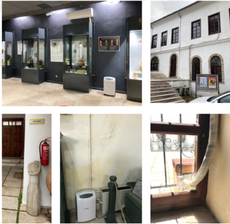
Şekil 5.12 Binadaki sorunlu donatılar (Giresun Erdoğan arşivi, 2022)
