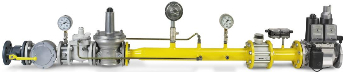
Şekil 2.2. Gaz Giriş Hattı
