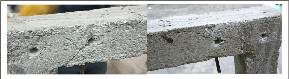
Şekil 4.70 Kirişin kolona bağlandığı yüzeylerde çaprazların kirişlerde oluşturduğu kesme etkisi.
