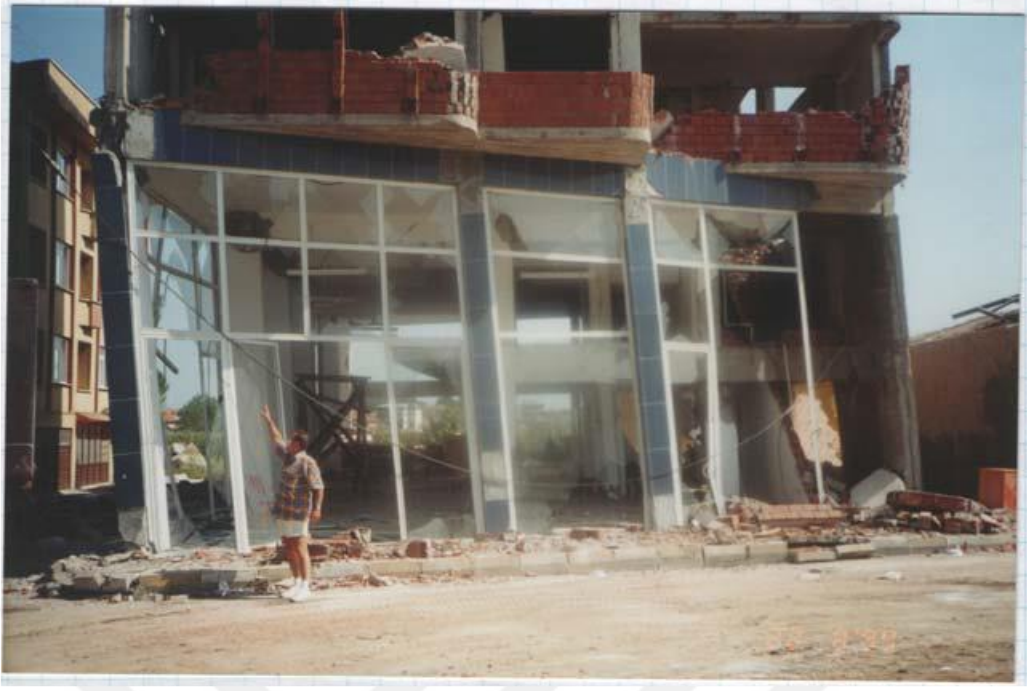
Şekil 1.6 Sakarya’da çok katlı yapının zayıf katında ağır hasar (Tezcan vd. 2007)-17 Ağustos 1999 Kocaeli Depremi, M = 7.4 ).
