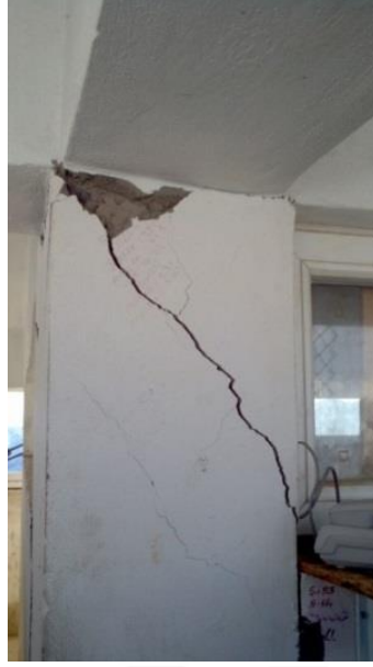
Şekil 1.13 Kısa kolonda oluşan tahribat (Yadollahi vd. 2016).
