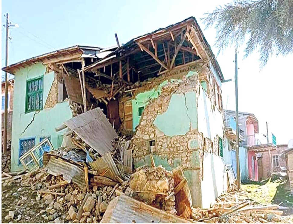
Şekil 1.4. Depremde bir kısmı yıkılmış bir yığma yapı (URL-4).
