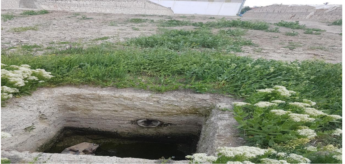
Şekil 4.19. Çalışma alanında inşa edilen silaj deposundan sızan atık suların bertarafı için inşa edilmiş rögar (Bolvadin, 2017)
