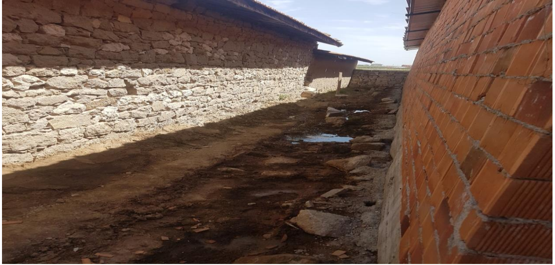
Şekil 4.36. Etüt alanında gübreden sızan sıvıların işletmeler arasında tahliye edilmesi (Sandıklı, 2017)
