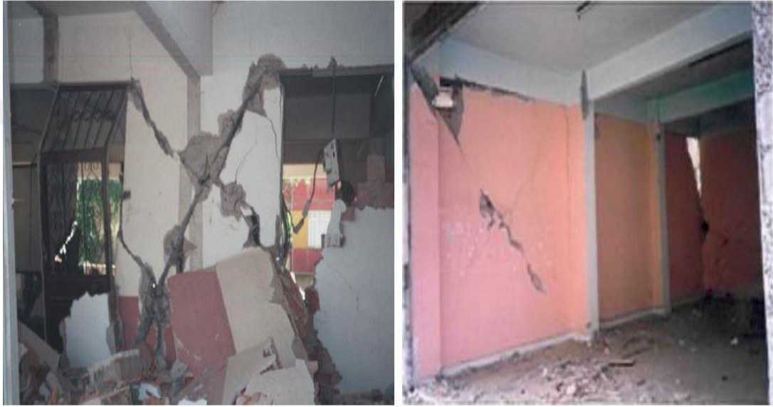
Şekil 2.1. Dolgu duvarlarda deprem etkisiyle oluşan kesme çatlakları
