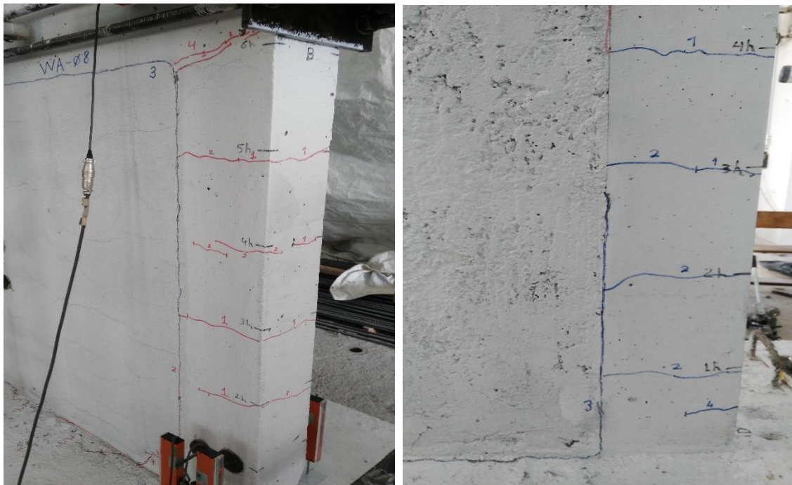
Şekil 4.15. 4. döngü sonunda oluşan çatlaklar ve ayrılmalar.
