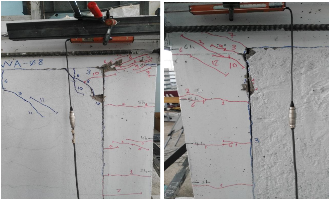
Şekil 4.17. 14. döngü sonunda çatlak ve dökülme durumu.
