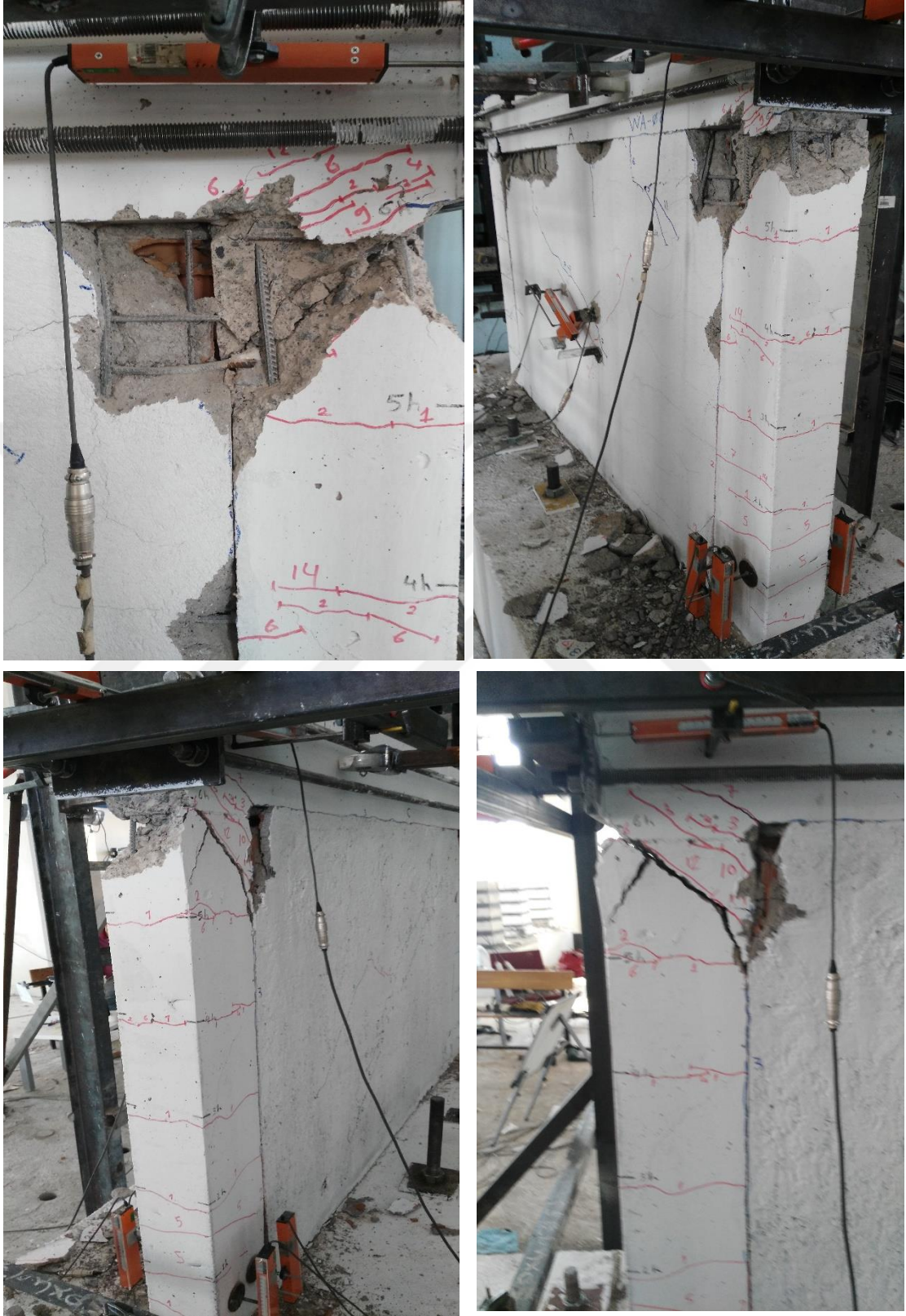
Şekil 4.19. 26, 28 ve 30. döngü sonunda çatlak ve dökülme durumu.
