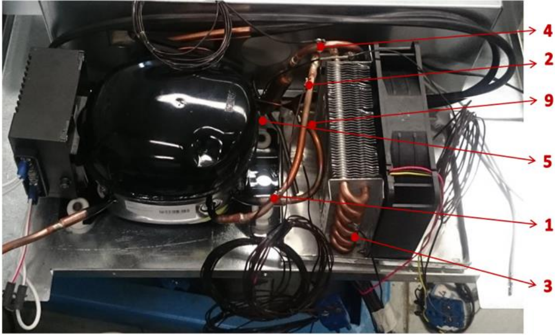
Şekil 3.4 : Kompresör grubu sıcaklık ölçme noktaları.
