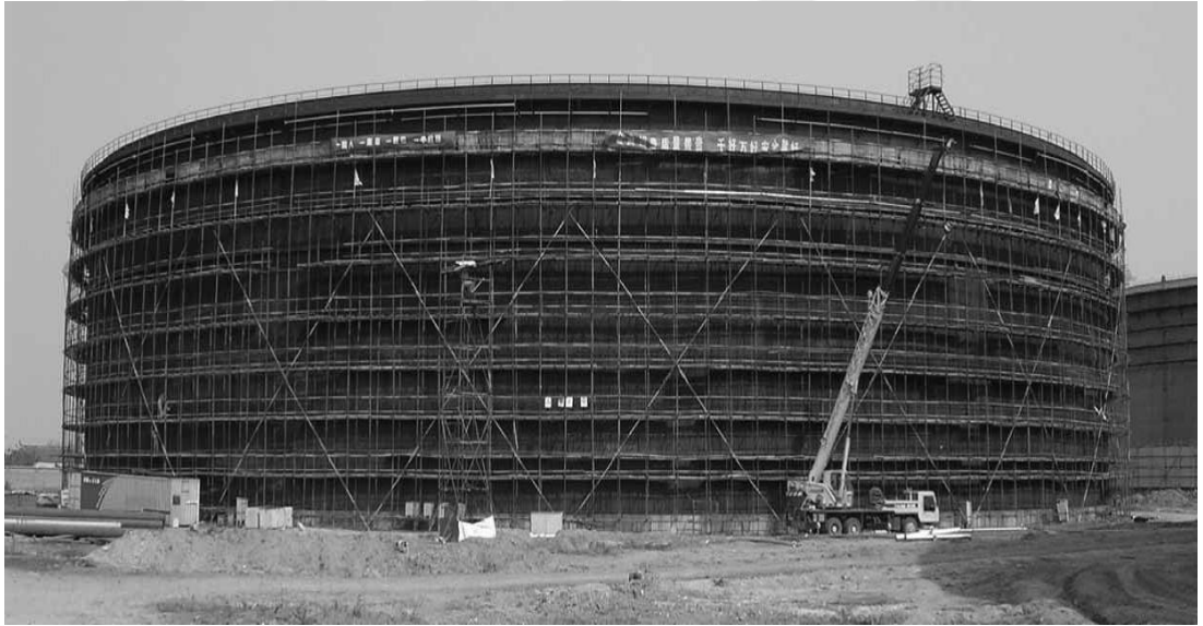
Şekil 4.1 : 150.000\text{m}^3 'lük petrol depolama tankı[12].
