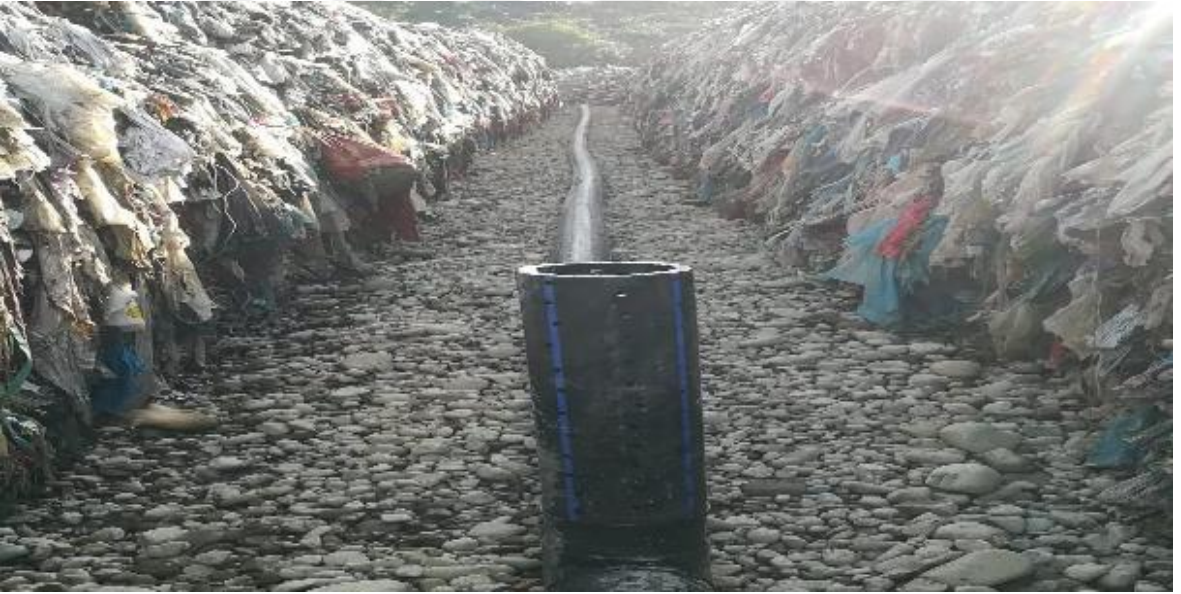
Şekil 65. Gaz toplama sisteminde gaz çekim noktası (TRAB-Rİ KAB)
