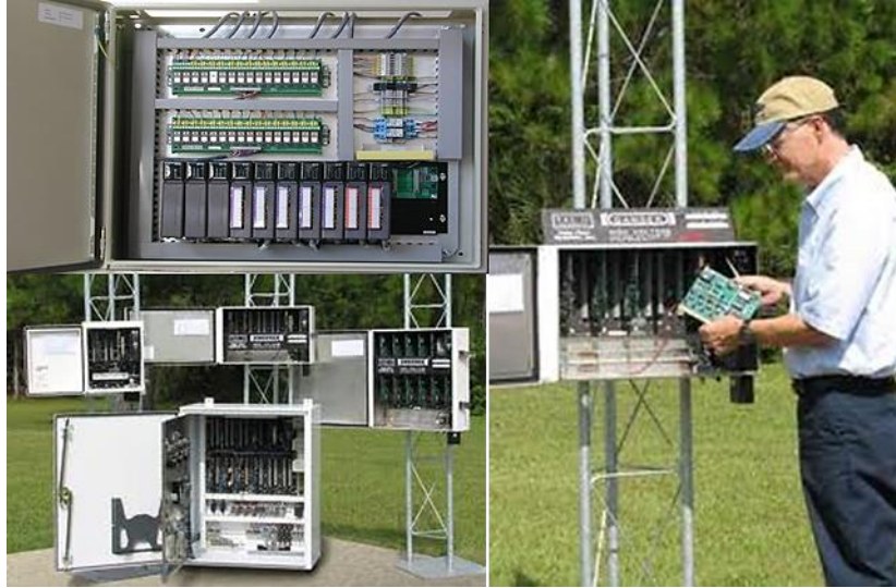
Şekil 3.9: SCADA sistemi saha örneği (GAZBİR, 2019).
