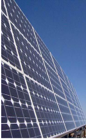
a) Fotovoltaik panel
