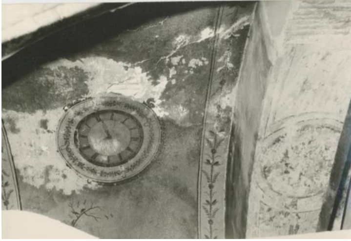
Foto. 153: İzmir (Merkez) Şadırvanaltı Camii,,tonoz, restorasyon öncesi durumu (1990 öncesi, V.G.M.'den)
