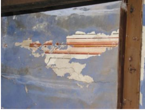
Foto. 33: İzmir, Bergama Ulu Camii Mahallesi'ndeki Ev, zemin kat, duvar yüzeylerindeki boyalı nakış izleri detay
