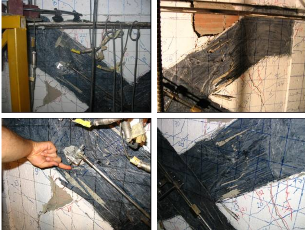
Şekil 4.34 : Numune N3'ün + 10.5 mm yerdeğiştirme adımının ilk itme çevriminde CFRP'nin kopması ve hasar durumu.
