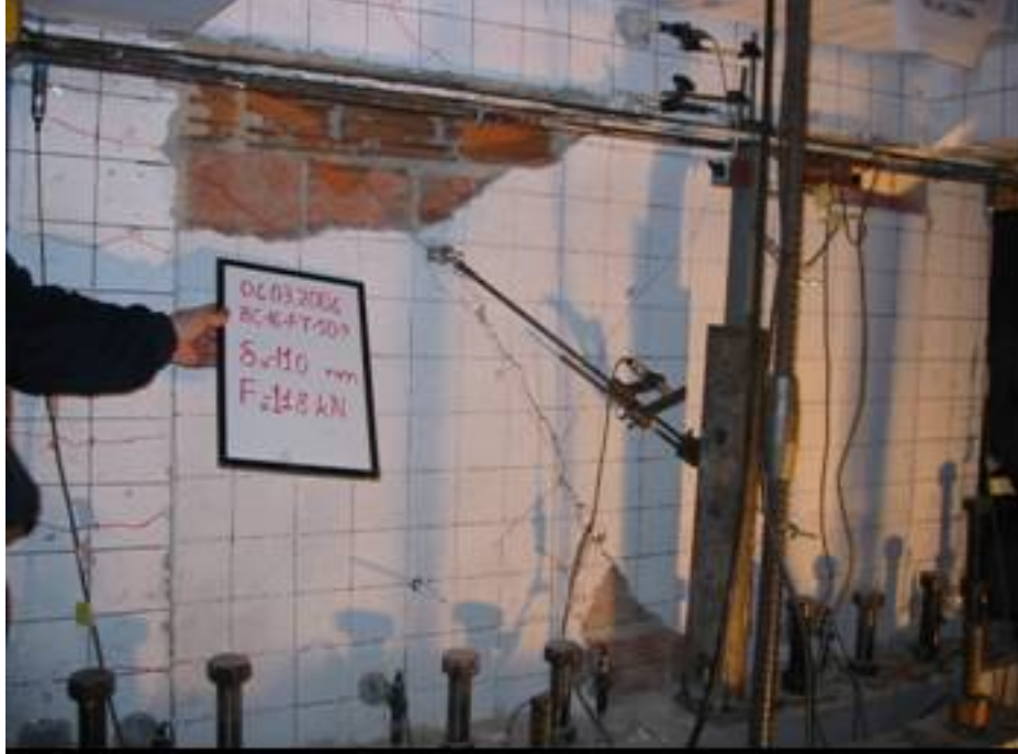
Şekil 4.22 : Numune N1'in \pm 11 mm yerdeğiştirme adımındaki hasar durumu.
