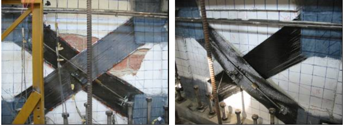
Şekil A.38 : Numune N3'ün -5.6 mm yerdeğiştirme adımındaki hasar durumu.
