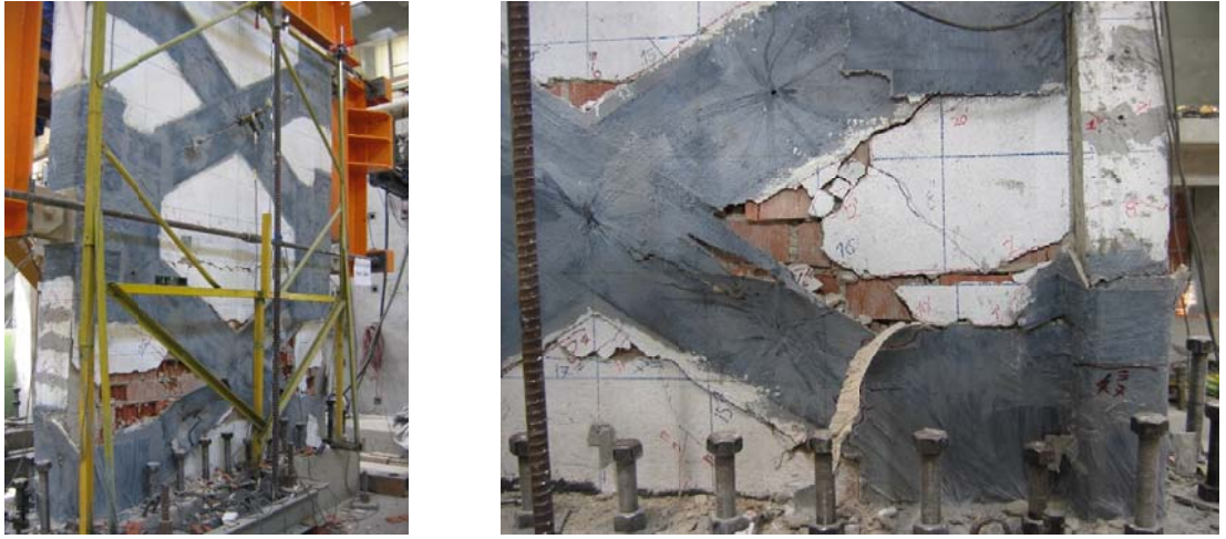
Şekil 5.17 : IL-C1'in ikinci deneyindeki hasar durumu.
