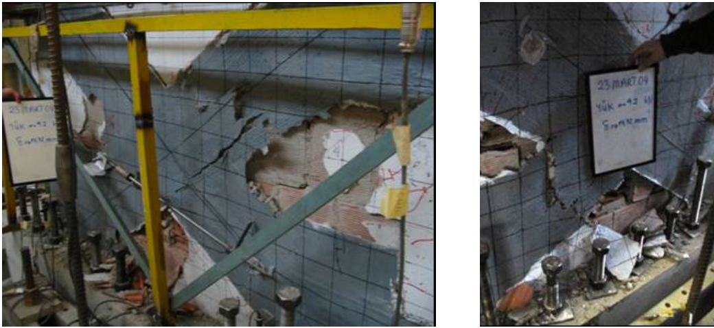
Şekil 4.29 : Numune N2'nin + 14 mm yerdeğiřtirme adımı üçüncü itme çevrimindeki hasar durumu.
