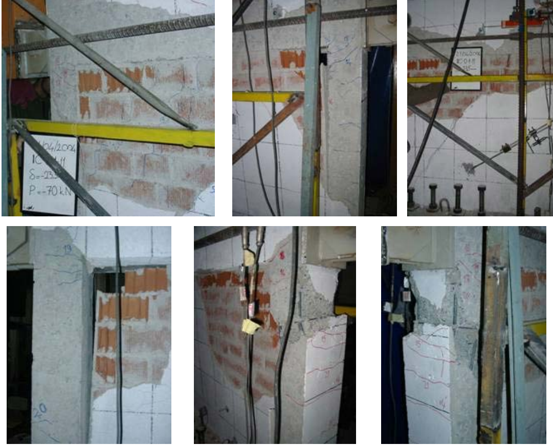
Şekil 5.10 : IC-0'ın hasar durumu.
