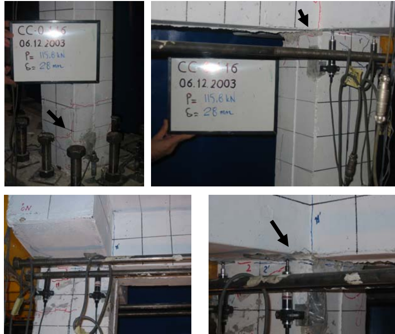
Şekil 4.18 : ‘Dolgu Duvarsız Numune 2’nin \pm 28 mm yerdeğiştirme adımındaki hasar durumu.
