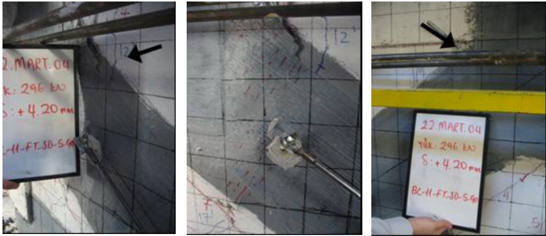
Şekil A.28 : Numune N2'nin +4.2 mm yerdeğiştirme adımındaki hasar durumu.
