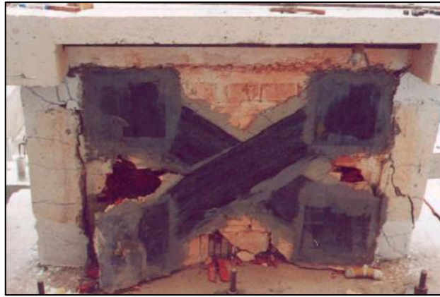
Şekil 2.4 : CFRP ile güçlendirilmiş dolgu duvarlı betonarme çerçeve numunesinin göçme şekli, (Karadoğan ve Yüksel, 2001).
