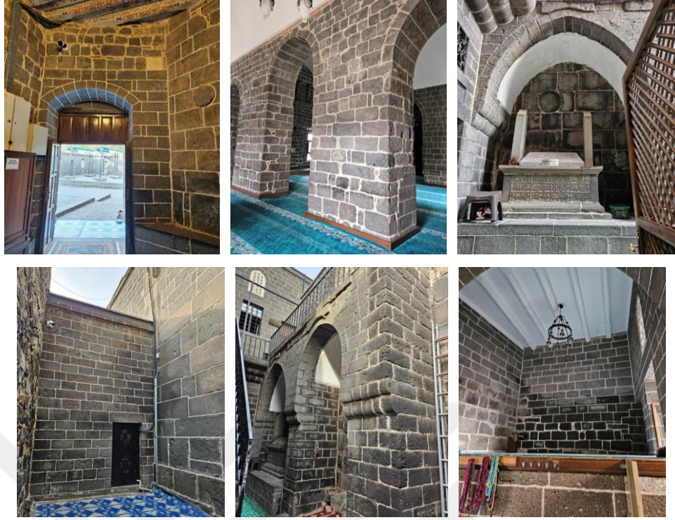
Şekil 4.47 Hz. Süleyman (Kale) Cami son cemaat yeri, harim bölümü ve kadınlar bölümündeki gözlemlenen hasarlar (2024)
