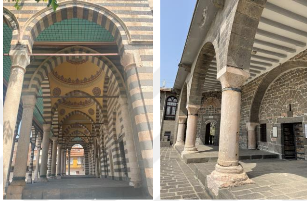
Şekil 3.24 Gergi çubuğu veya bileziğinin meydana getirdiği çatlak oluşumu ve yüzeysel hasarlar (2024)
