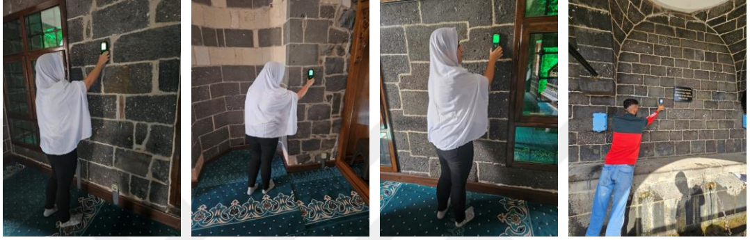
Şekil 4.76 Hiz. Süleyman (Kale) Cami’de nem durumunun belirlenmesi (2024)
