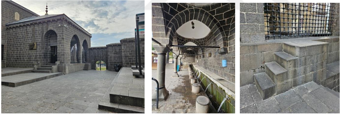
Şekil 4.42 Hız. Süleyman (Kale) Cami’de avludaki zemin taşlarında, çeşmelerin üzerindeki duvarlardaki ve türbe basamaklarındaki aşınmalar ve derz boşalması (2024)
