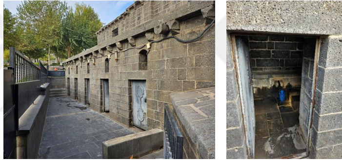
Şekil 4.50 Hz. Süleyman (Kale) Cami’de helâ bölümünde gözlemlenen hasarlar (2024)
