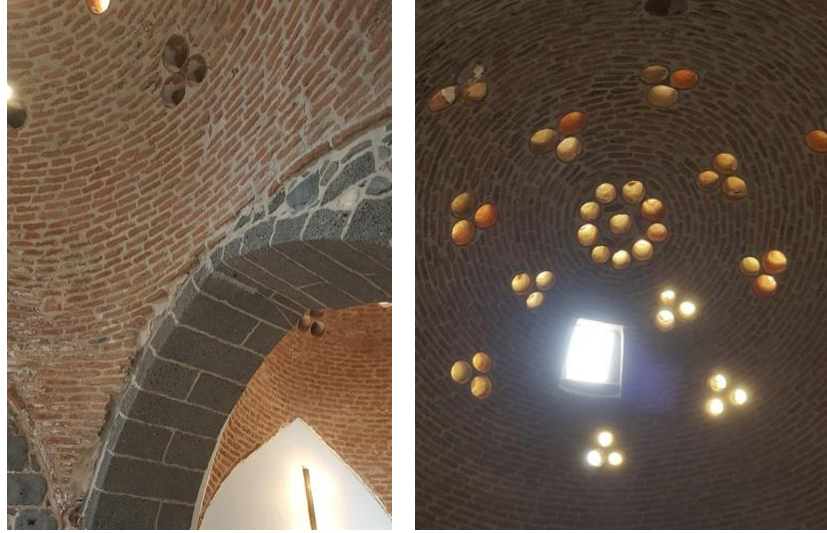
Şekil 3.30 Vahap Ağa Hamamındaki fil gözlerinin plastik içerikli bir malzemeyle kapatılmasıyla oluşan yoğunlaşma sonucu derzlerin boşalması (2024)
