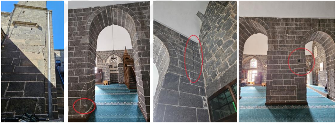
Şekil 4.44 Hz. Süleyman (Kale) Cami’de minarede ve harim bölümünde gözlemlenen hasarlar (2024)
