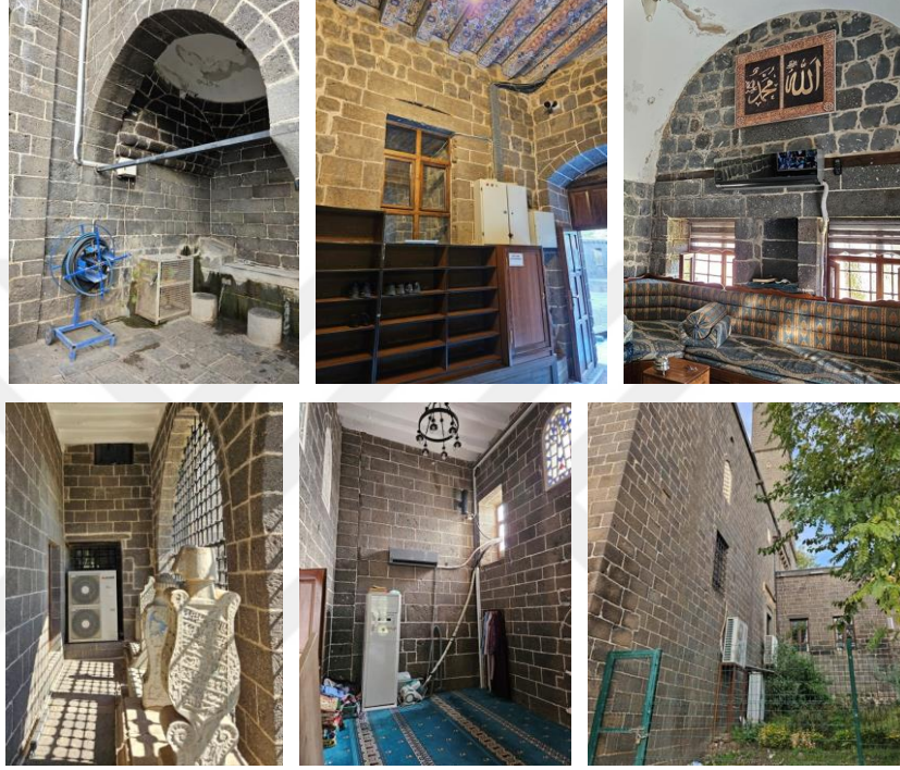
Şekil 4.52 Hz. Süleyman (Kale) Cami’de insanların neden olduğı sorunlar (2024)
