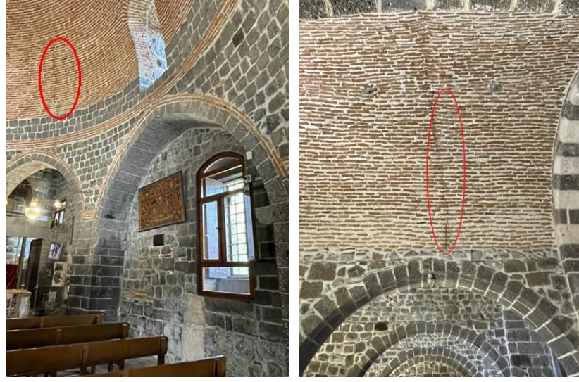
Şekil 3.28 Diyarbakır Süryani Kadim Meryem Ana Kilisesi kubbesinde tuğla çatlakları (2024)
