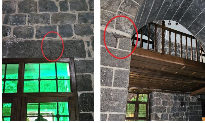
Şekil 4.39 Hz. Süleyman (Kale) Cami’de lentoda ve kemer gözlemlenen çatlaklar (2024)
