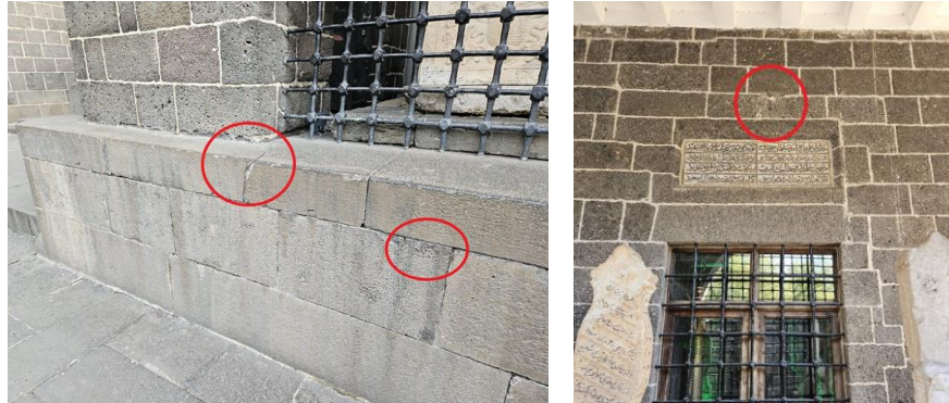
Şekil 4.41 Hz. Süleyman (Kale) Cami’ de türbede gözlemlenen çatlaklar (2024)
