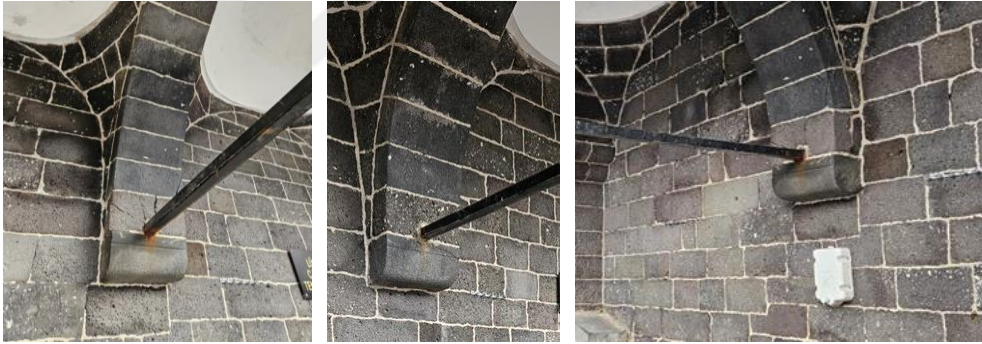
Şekil 4.40 Hz. Süleyman (Kale) Cami’de abdest alma bölümünde gözlemlenen çatlaklar (2024)
