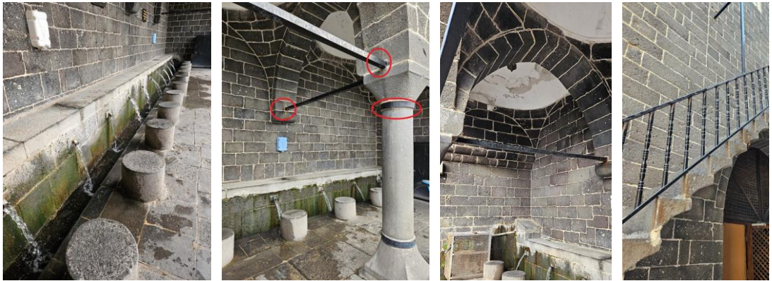
Şekil 4.46 Hz. Süleyman (Kale) Cami abdest alma bölümünde gözlemlenen hasarlar (2024)
