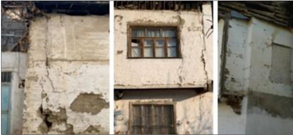
Şekil 3.14 Zemin kaynaklı çatlak oluşumları (Kuşaslan, 2002)
