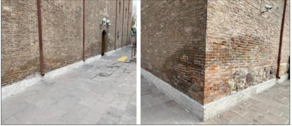
Şekil 3.20 Tuğla duvarda nem sorunundan kaynaklanan hasarlar (Pala ve Koç, 2022)
