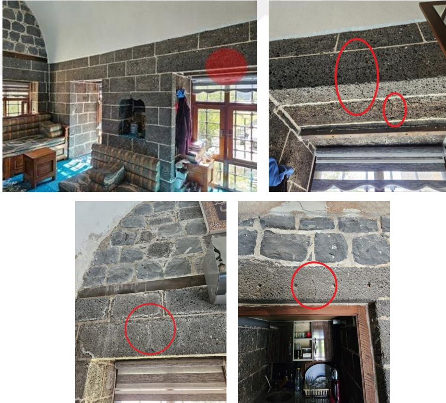
Şekil 4.38 Hz. Süleyman (Kale) Cami’de imam odasında gözlemlenen çatlaklar (2024)
