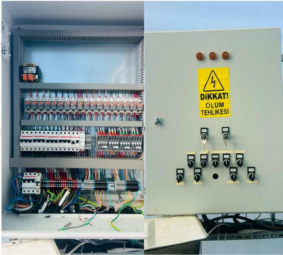
Şekil 2.7. İklimlendirme kontrol panosu
