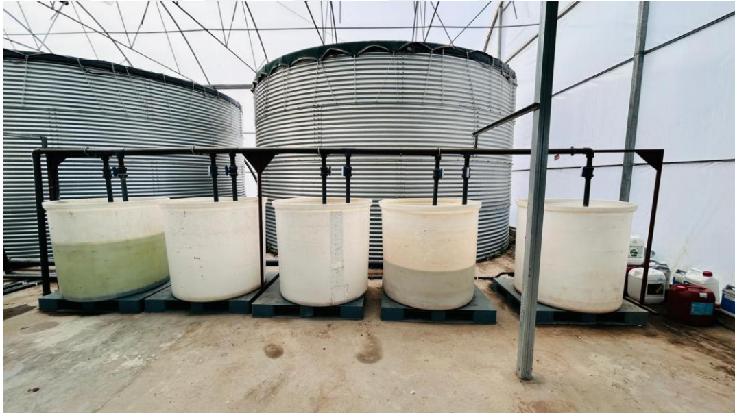
Şekil 3.7. Gübreleme sistemi karıştırma kazanları
