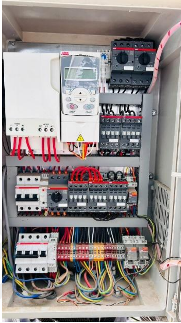
Şekil 3.5. Sulama sistemi kontrol panosu
