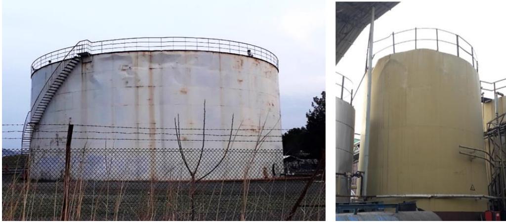
Şekil 2.13 Sıvının çalkalanması sonucu tank duvarındaki hasarlar
