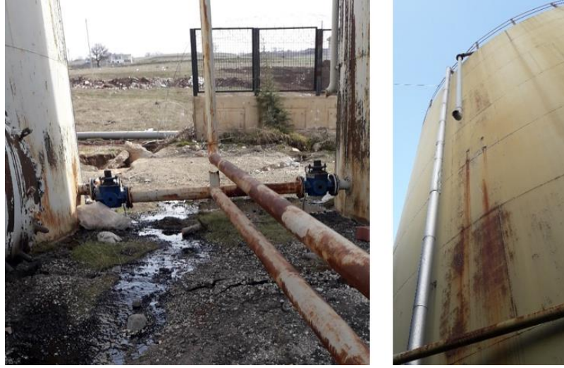
Şekil 2.12 Boru ve bağlantı elemanlarındaki hasarlar
