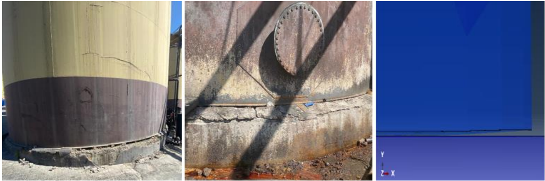
Şekil 4.2 Tankın yükselmesi sonucu taban plakasında deformasyonlar ve betonun dökülmesi.
