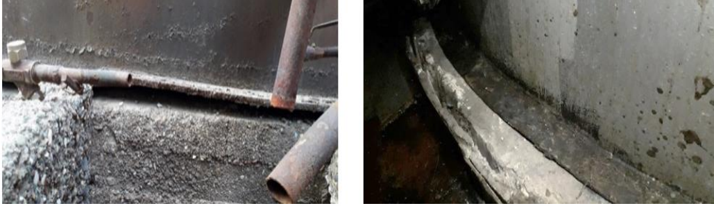
Şekil 2.10 (a) Yükselme deformasyonları (b) Tank tabanının kayması
