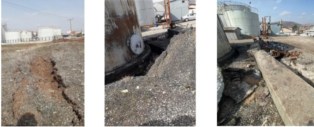
Şekil 2.9 Tank çifliğinin ortasından geçen (a) fay kırığı, (b) temelin yerinden oynaması, (c) beton çatlama hasarları
