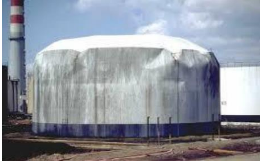
Şekil 2.4 Çalkalanma hasarları (Kocaeli-1999)
