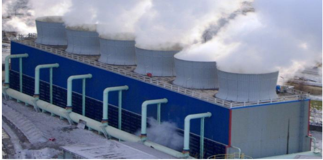
Görsel 3.4: Soğutma Kulesi Saha Görseli
