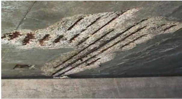
Resim 2.10. Karbonatlaşma sonucu donatı korozyonu
