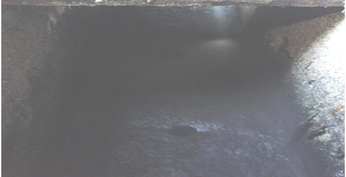
Şekil 4.6: Havalandırma ünitesi dağıtım yapısında yağ ve tortu birikimi.
