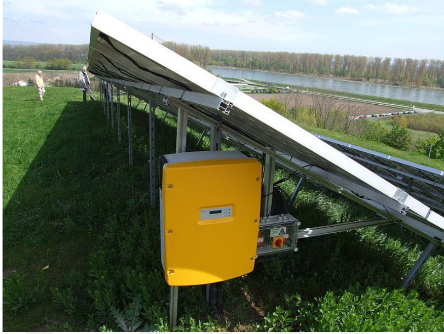
Şekil 4.23. PV panel sistemi inverter bağlantısı
