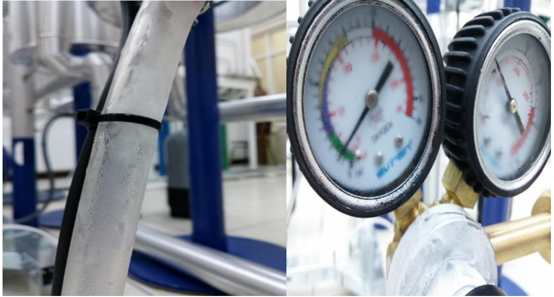
Şekil 4.16 : Tahliye hattı ve regülatörde meydana gelen donma olayının görseli.
