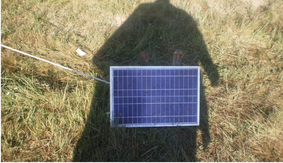
Şekil 3.16 Yaylada elektrik enerjisi elde edilen güneş panosundan bir görünüm
