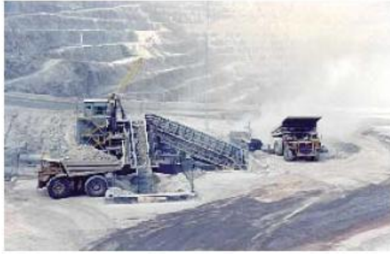
Şekil 3.4 İki kamyon boşaltma silosuna sahip yarı mobil kırma tesisi.
