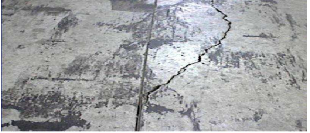
řekil 3.3. Otopark zemin kaplamasında kuruma rtresi atlaėı.
